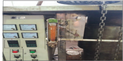
تابلو برق کوره دو قلو
